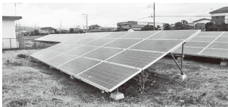
▲ 市内に設置されている太陽光発電設備
